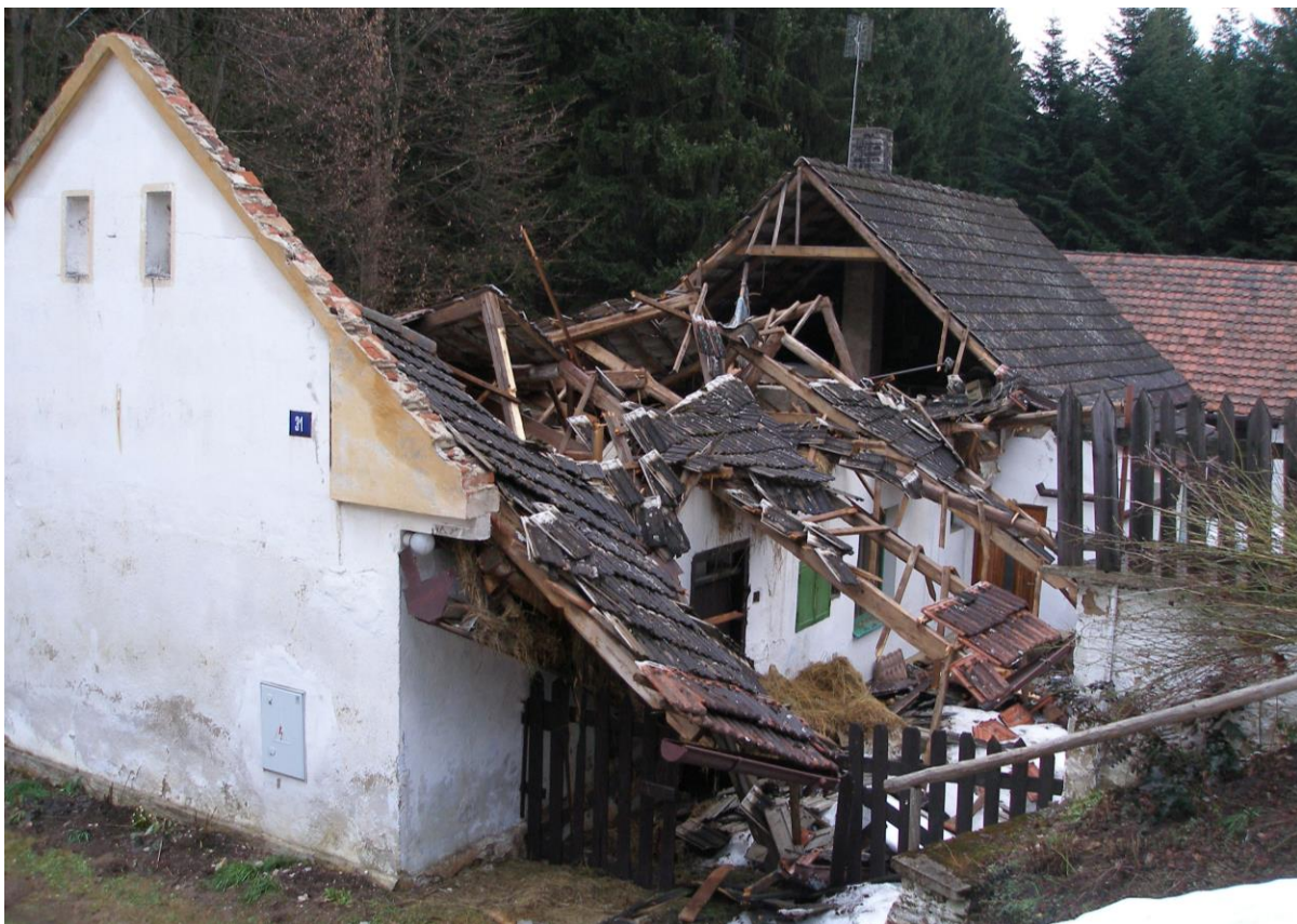
Rok 2006: Pod tíhou sněhu propadá střecha na č. p. 31
